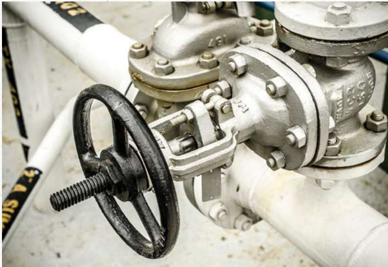
Actuadores sobre válvulas
