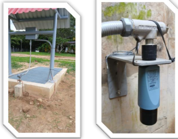
Medidores de vertimientos estación Cusiana
