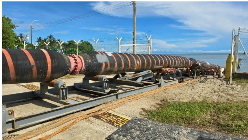
Ingreso de string de mangueras flotantes Nro. 3 al Lote Playa del Terminal Marítimo Coveñas.
