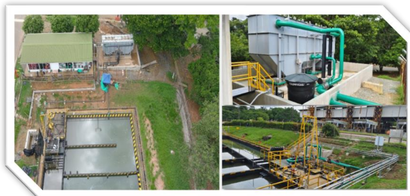
Separador de placas corrugadas, estación Caucasia.
