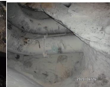
Tubería con polvo de extintores después del evento de fogonazo
