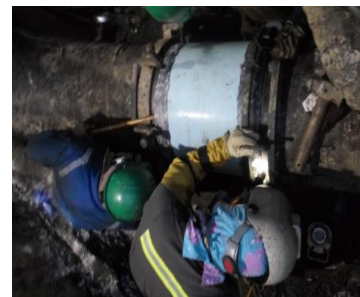
Tubería para intervenir
